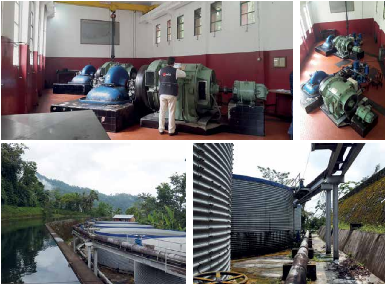
Figura 39 Fotografias da Central Hidroeléctrica do Contador / Fonte: ALER, 2016
