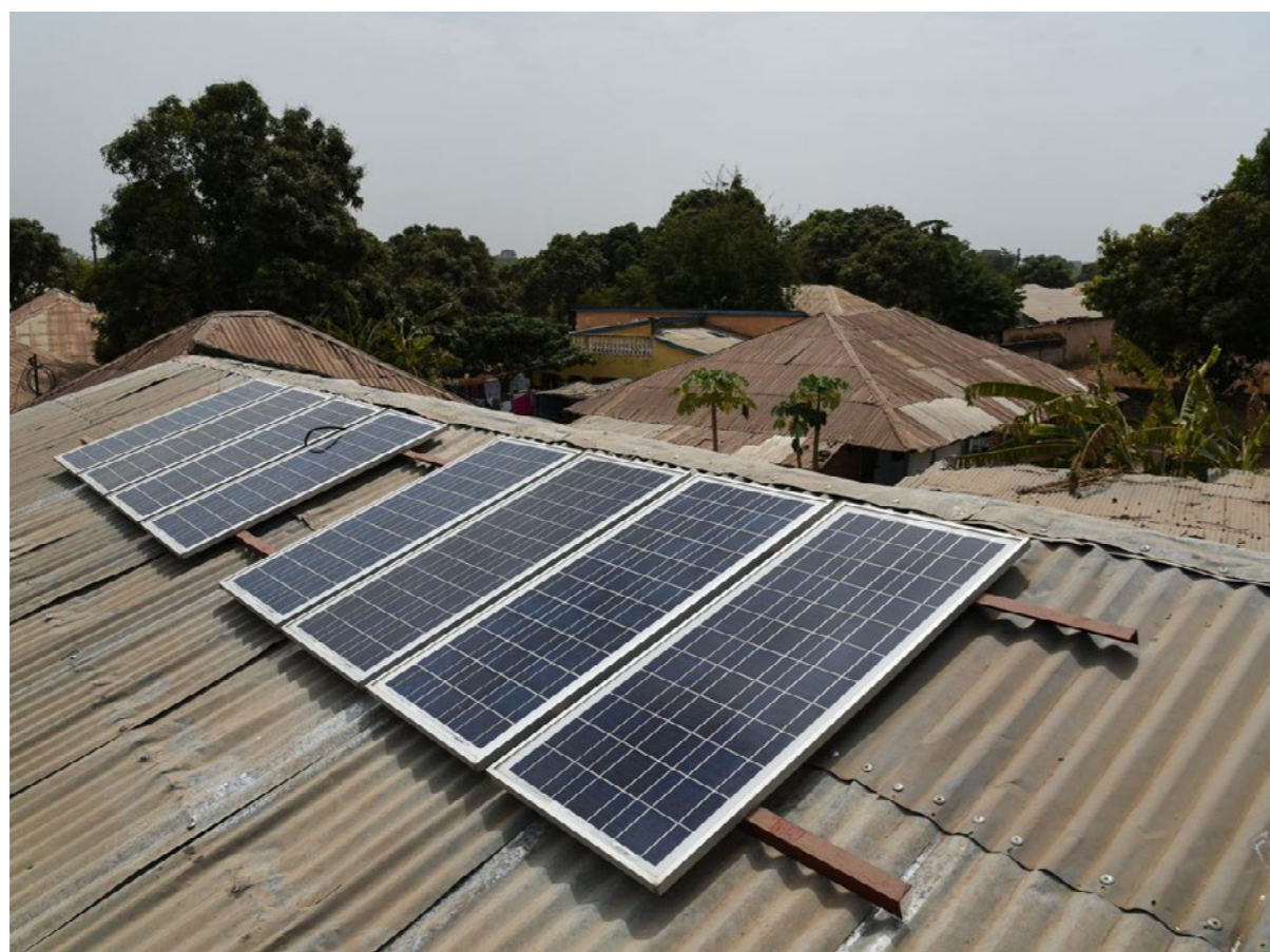
Figura 7: Sistema solar caseiro instalado.
