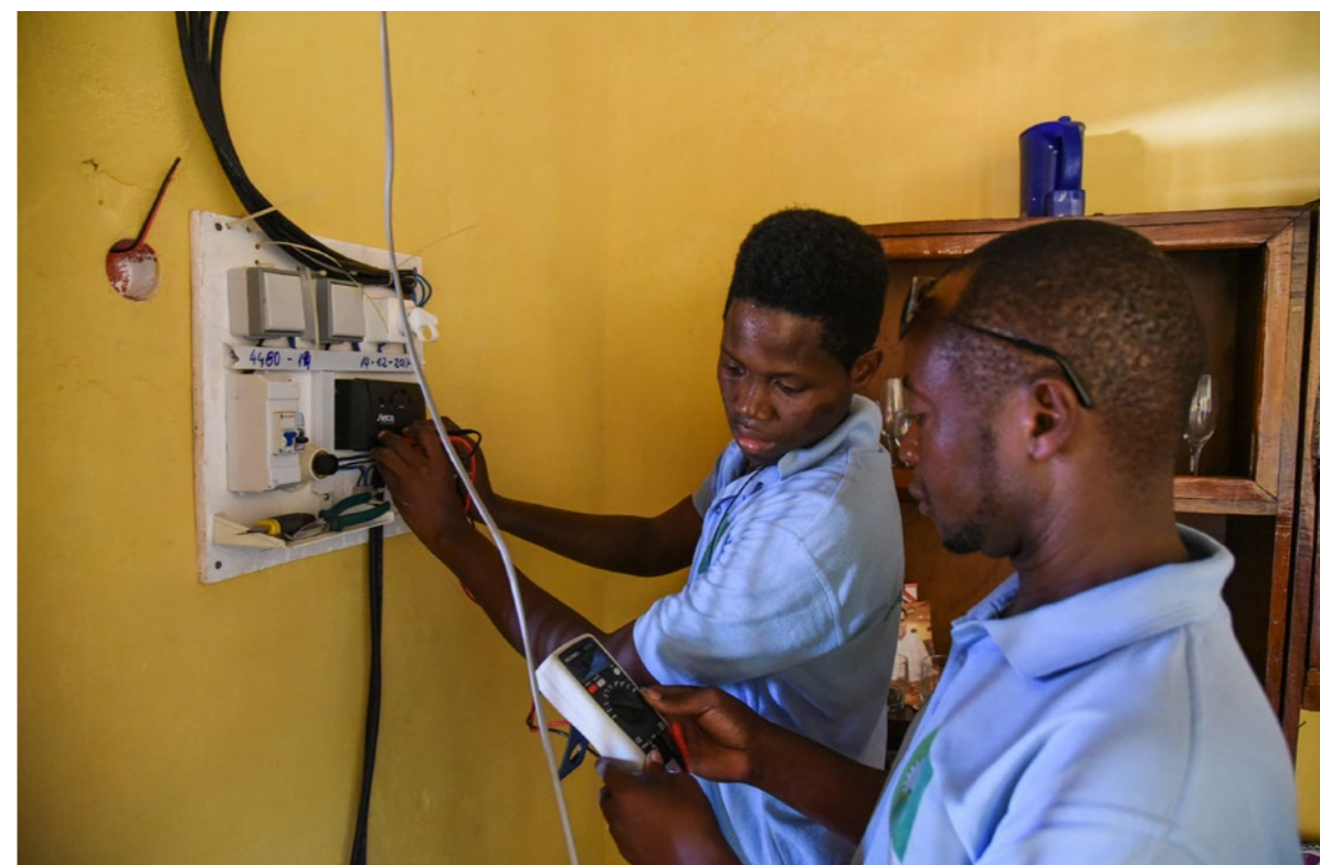
Figura 6: Instalação do sistema solar caseiro por técnicos da FRES. Figure 6: Instalation of the solar home system by FRES staff.
