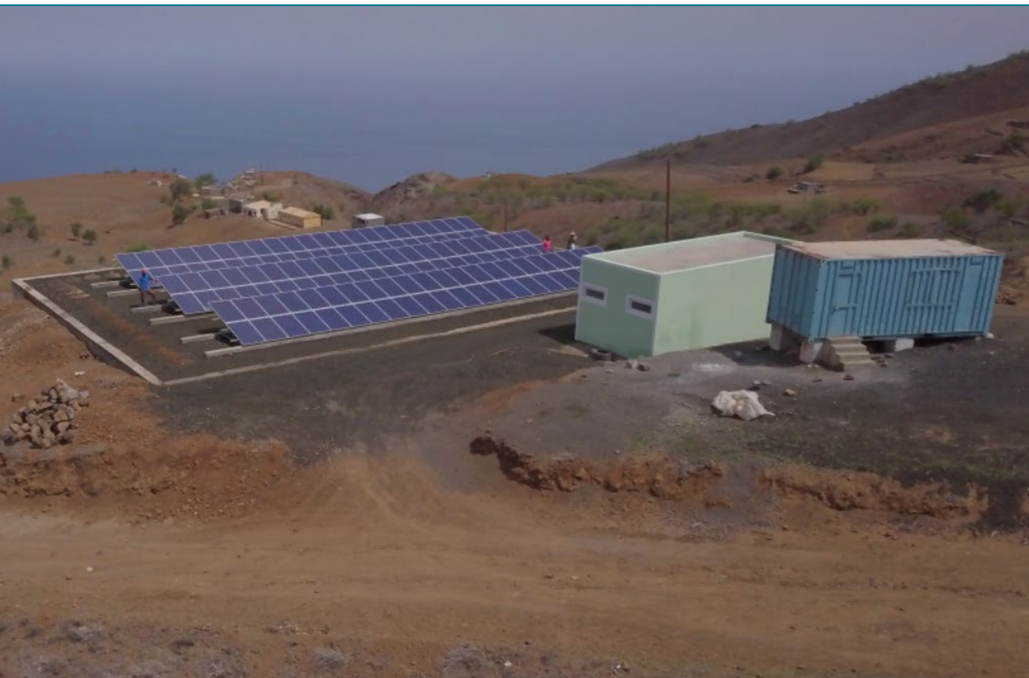
Figura 1: Central fotovoltaica de Planalto Norte. Figure 1: Planalto Norte Solar Power Plant
