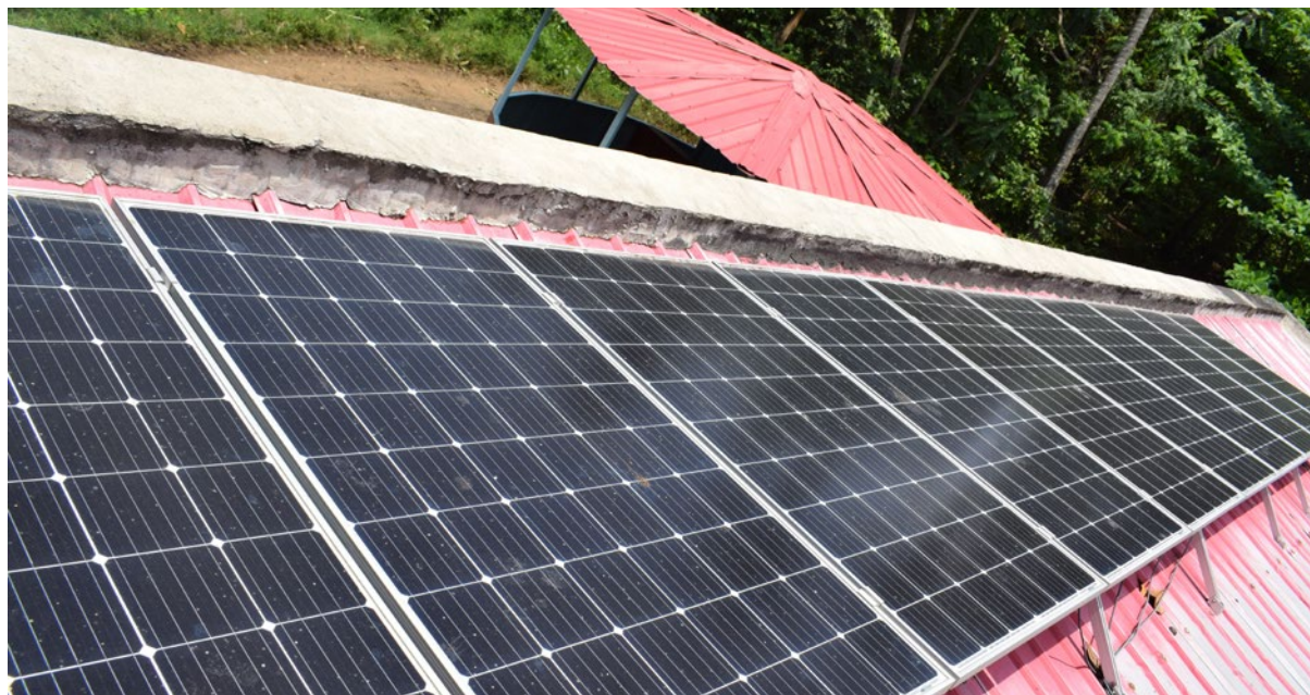
Figura 2: Paineis fotovoltaicos instalados.
