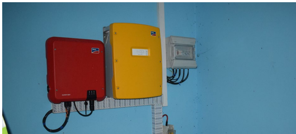
Figura 3: Painel do sistema instalado.
