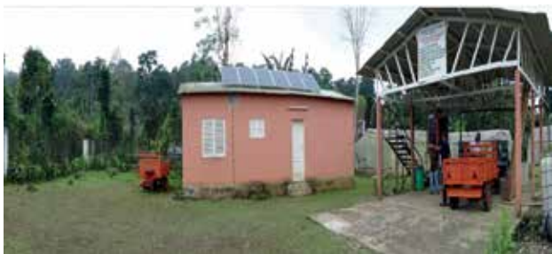
Figura 39 Instalação PV na Cooperativa de café biológico da comunidade de Bem-posta realizada no âmbito do PAPAC /
