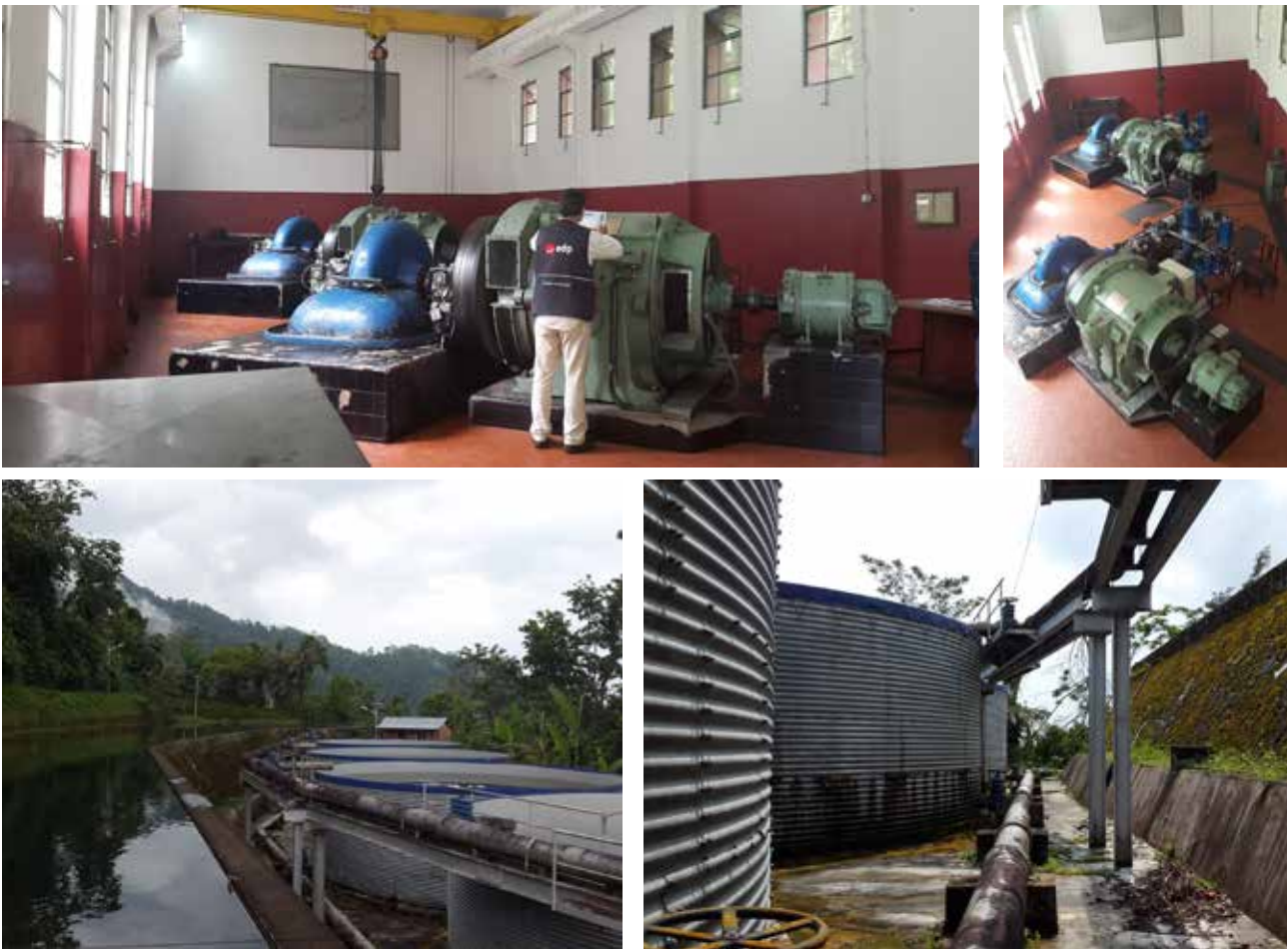
Figura 43 Fotografias da Central Hidroeléctrica do Contador / Fonte: ALER, 2016
